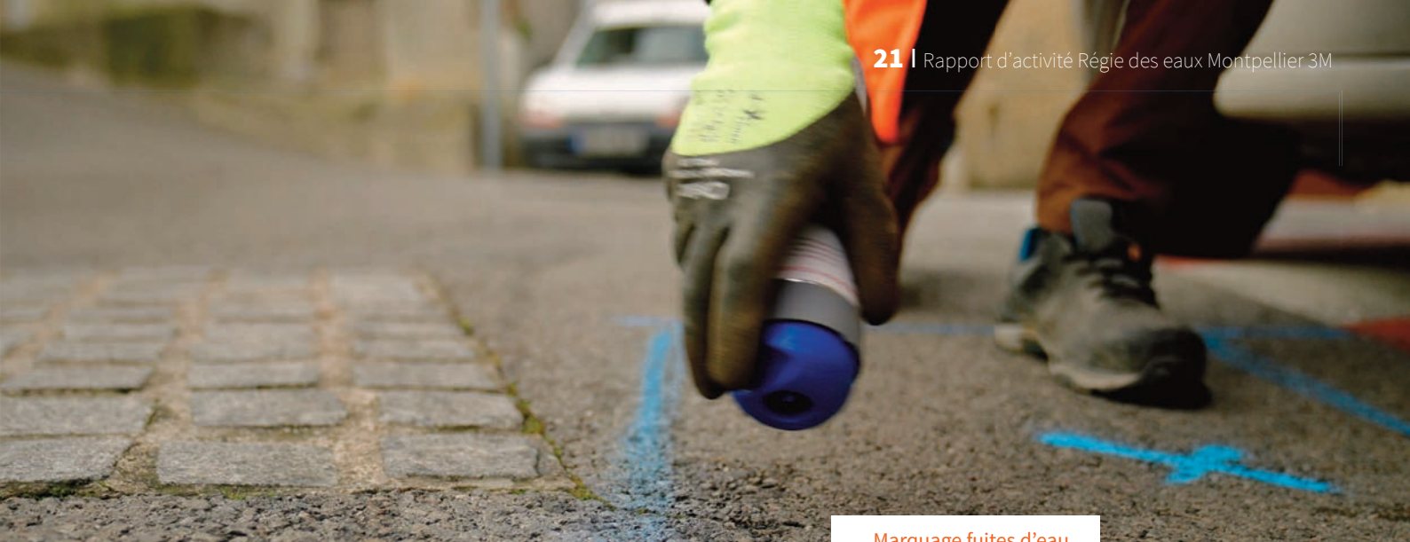
Marquage fuites d'eau
