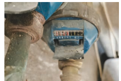
L'entretien et le renouvellement des compteurs sont assurés par les agents de la Régie des eaux
