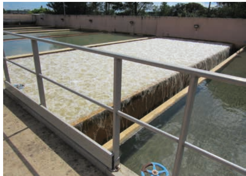
Station François Arago - Nettoyage des filtres à sable
